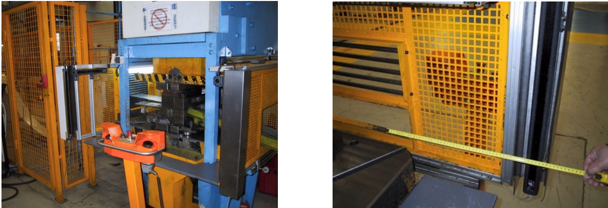
Fig. 13 – Exemplo de colocação de estrutura fixa que impede a permanência do tronco de um trabalhador na zona (S)
